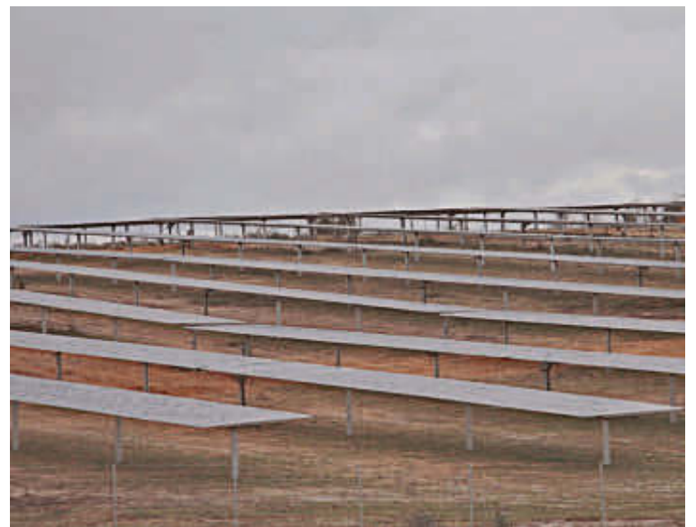
Valdelosa estrenó en 2019 el mayor complejo fotovoltaico de la Región. | EÑE
