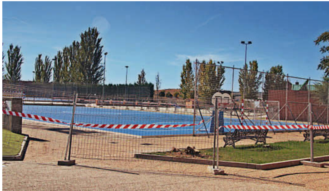
El nuevo pabellón de Carbajosa ocupará la pista del complejo deportivo exterior. | EÑE
