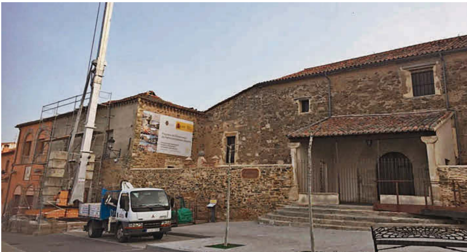
Las obras para desmontar el antiguo e inservible tejado del edificio del Hospital de Santiago y San Marcos ya han comenzado. | EÑE
