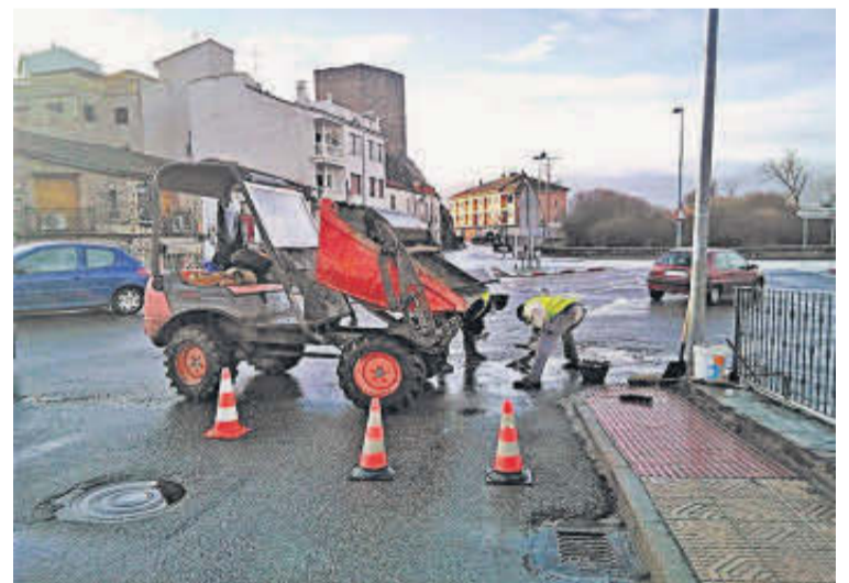
Los operarios en las tareas de reparación de firme en Alba. | EÑE
