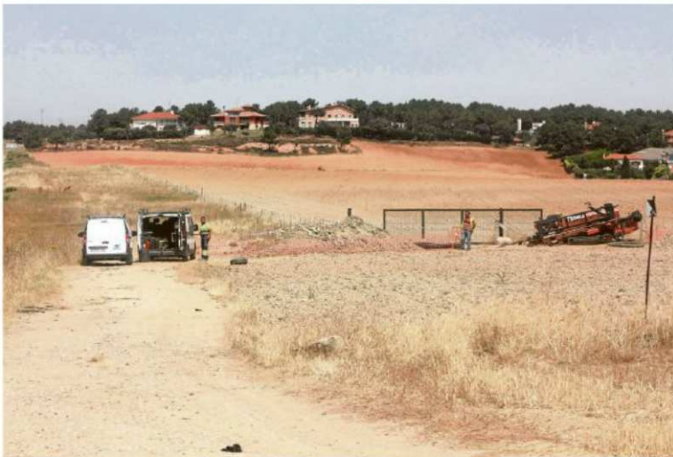
Los trabajos de la nueva canalización desde la urbanización El Pinar de Alba hasta el casco antiguo de Terradillos. | EÑE
